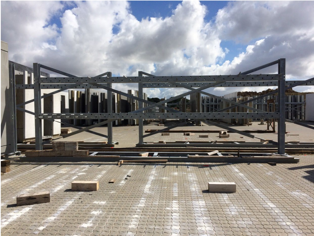
CSP-CER hos en producent af beton elementer
