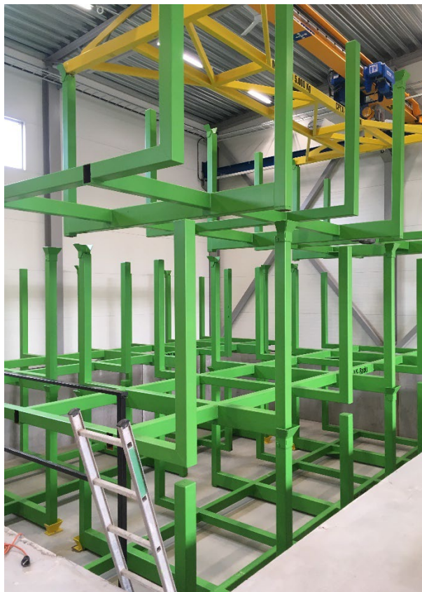
Stål racks samt løfte-åg
